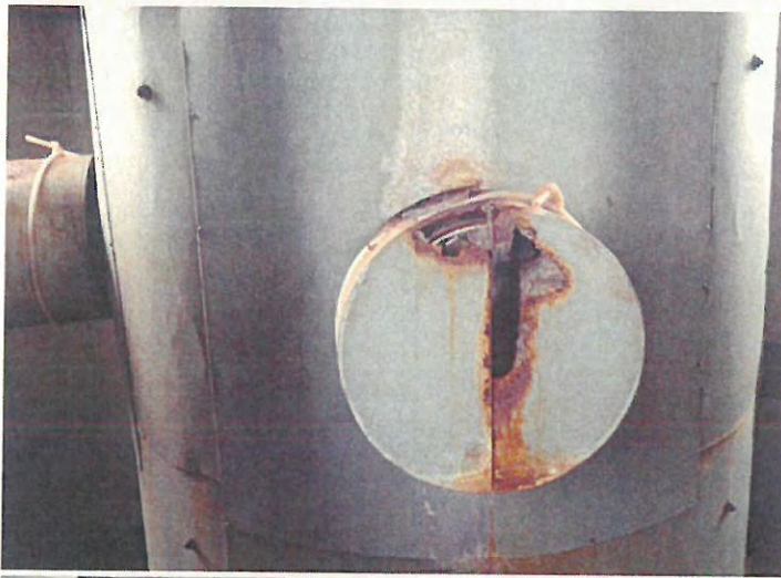
写真 2-08 2号炉煙突内筒分析口 腐食
