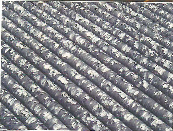
写真共-02 高圧蒸気復水器フィンチューブ
