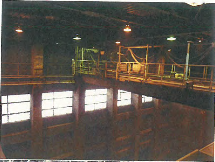
写真共-01 ごみクレーン
