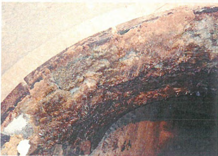
写真 2-03 2号炉燃焼段出口クリンカー
