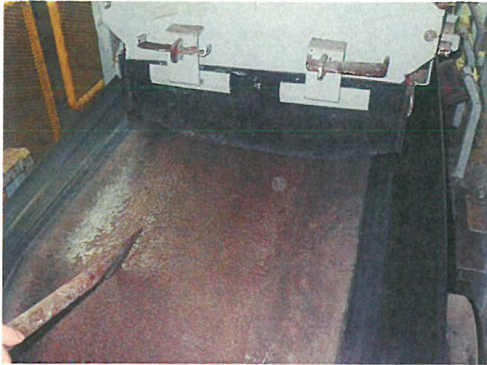
写真 共-04 養生コンベア
