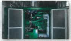
バイオガス発電機
