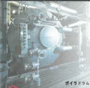
ボイラドラム
